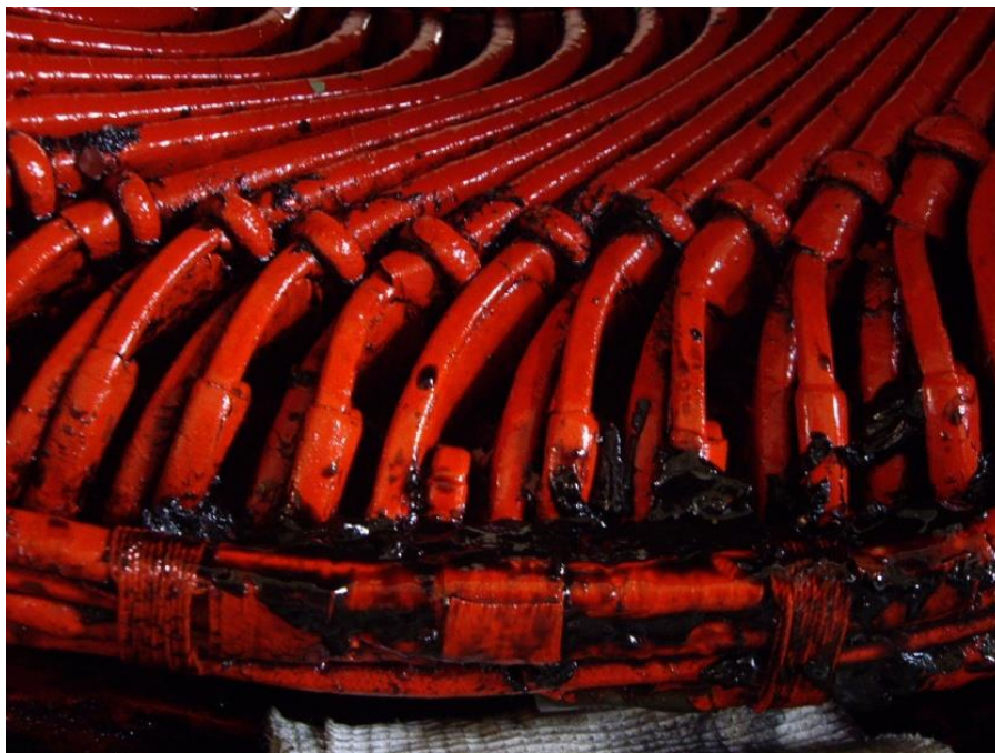
Рис. 4. Пример загрязнения обмотки статора испытываемого АЭД
