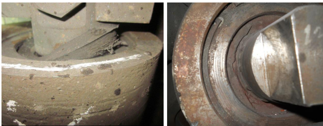
Рис. 3. Нарушения целостности сайлентблока головки поводка подвешивания ТЭД к раме тележки
