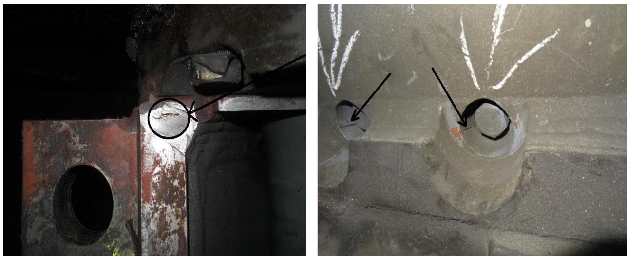
Рис. 2. Трещины в корпусе МОП и в кронштейне крепления подвода к ТЭД
