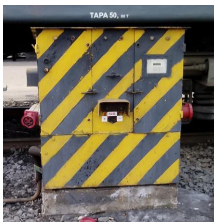
Рис. 3. Общий вид электроколонки существующей инфраструктуры
