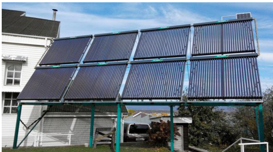
Рис. 4. Общий вид солнечных коллекторов вакуумного типа
