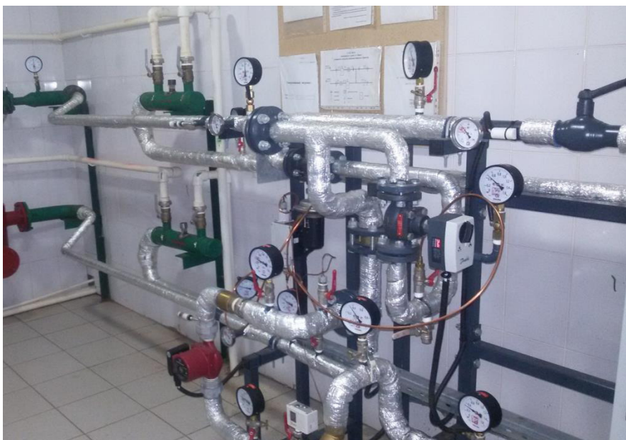
Рис. 1. Блочный индивидуальный тепловой пункт (БИТП) – здание дома отдыха локомотивных бригад ст. Омск-Пассажирский
