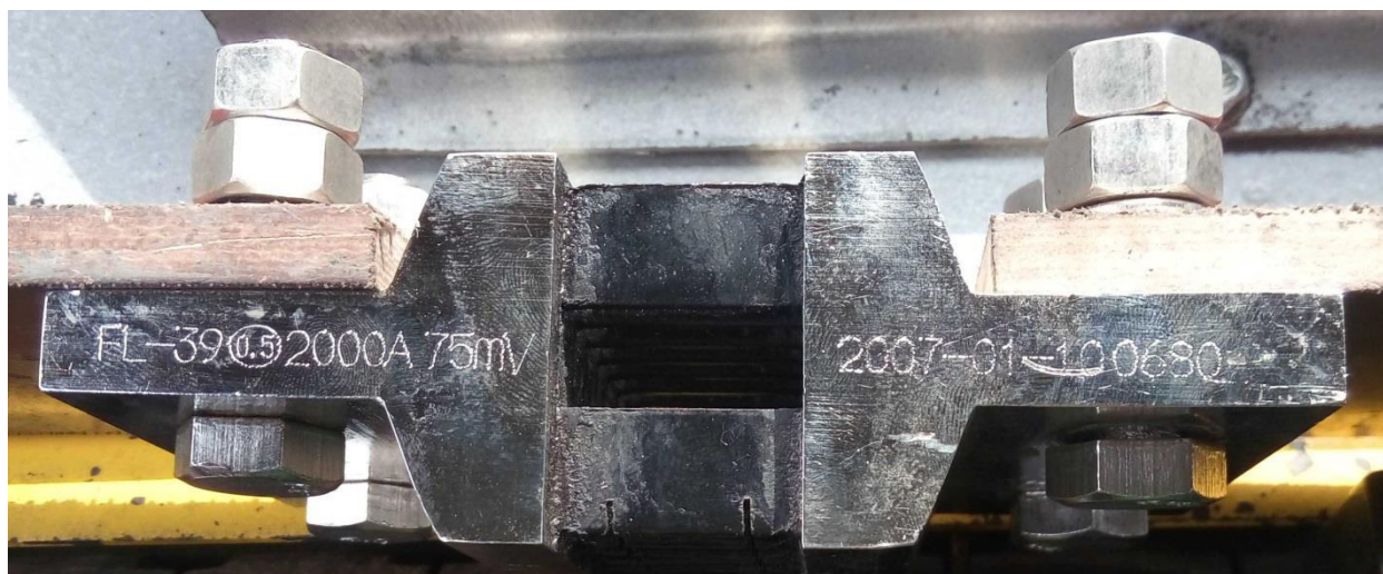
Рис. 4. Вид установленного на изоляторе шунта
