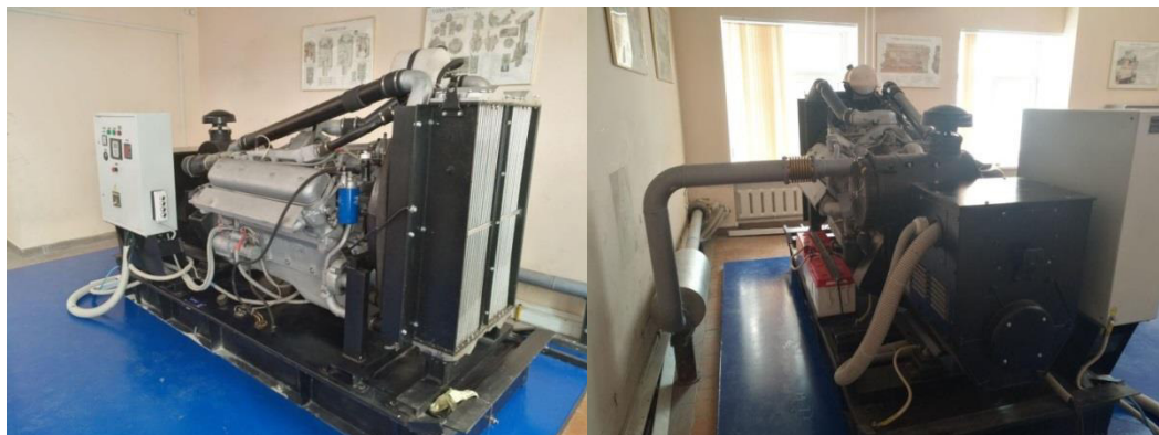
Рис. 6. Устройство выпускной системы дизель-электростанции после модернизации.
