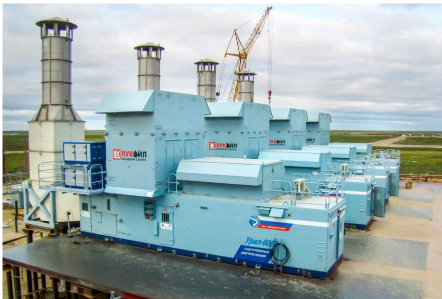
Рис. 1. Газотурбинная блочно-модульная электростанция ГТЭС «Урал-6000»
