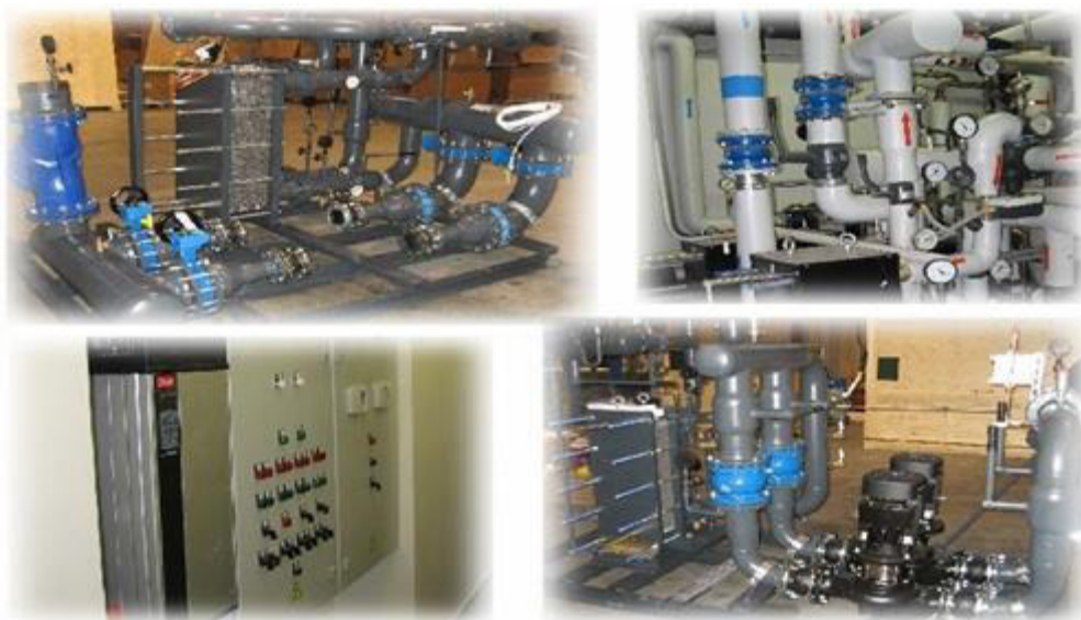
Рисунок 2 – Автоматизированные индивидуальные тепловые пункты
