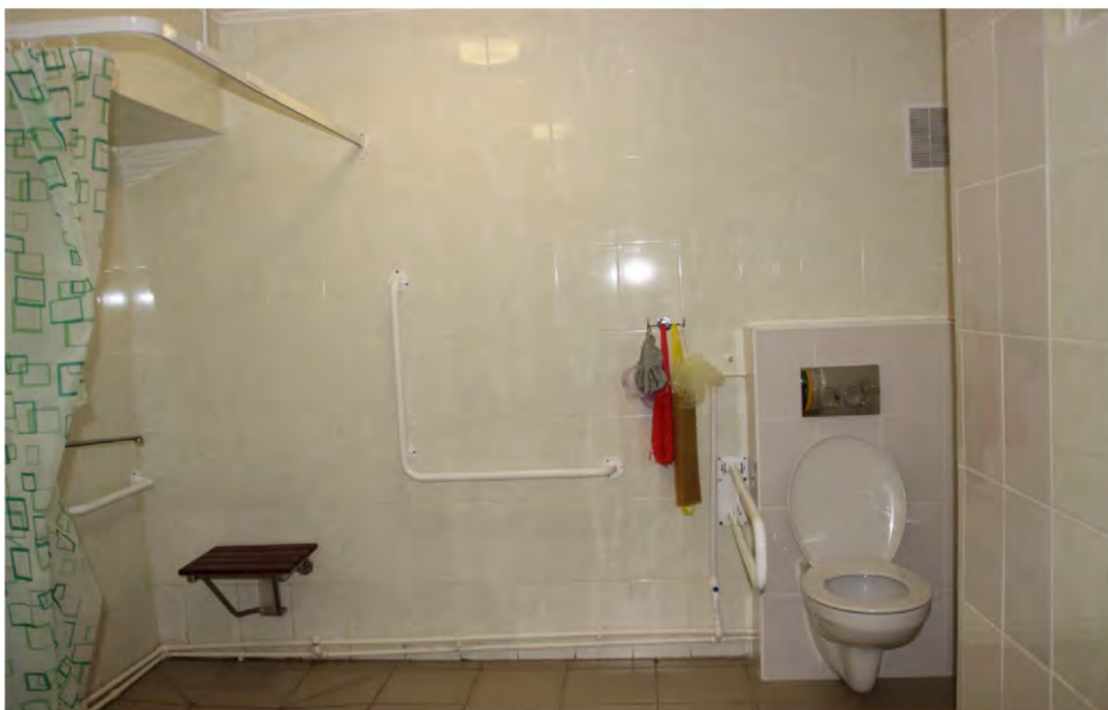
Санузел оборудованный специальными санитарно-бытовыми приборами, душем с откидными скамейками и поручнями для МГН (общежитие № 4)
